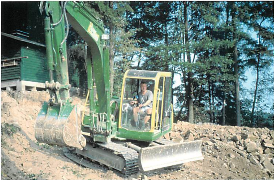
Nun geht es los. Der Bagger von Fa. Klute, Garten- und Landschaftsbau, beginnt mit der Ausschachtung der Baugrube für den Hüttenanbau.
