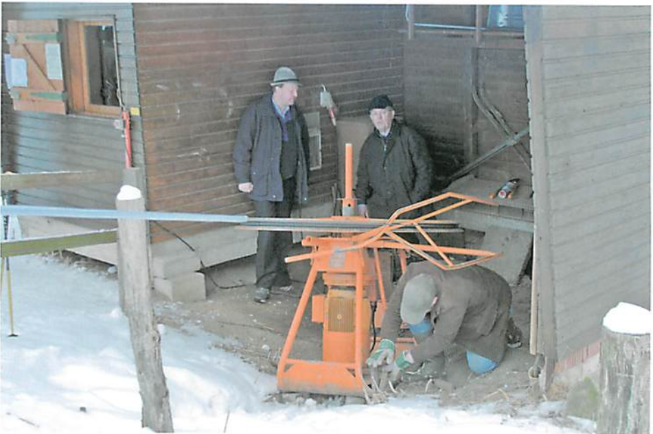
Na Clemens, steht der Lift richtig? Scheint hier Werner Starke zu fragen. Unter den strengen Augen des Liftpersonals werden noch letzte Feinarbeiten durchgeführt.
